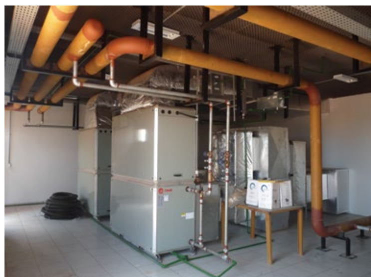
Engenharia aplicada a condicionamento de ar
