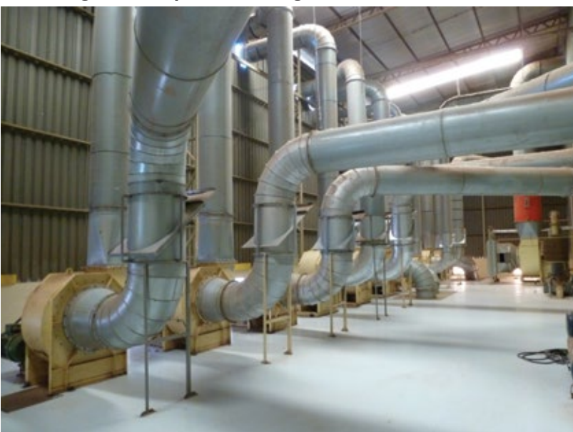
Engenharia aplicada na organização de ventiladores
